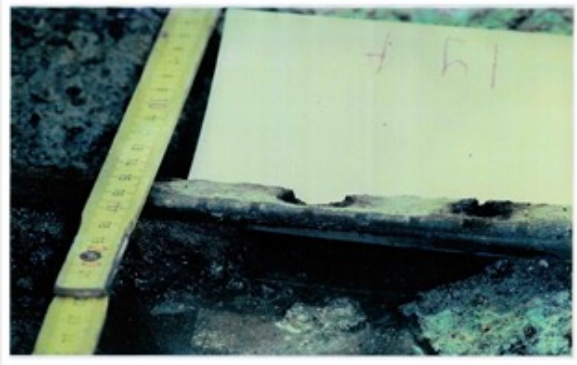
Corrosione localizzata dovuta alla penetrazione di ioni cloruro
