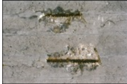
Corrosione uniforme e distacco del CLS dovuto alla carbonatazione
