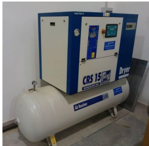
Figura 15: Compressore utilizzato per i sistemi di controllo (servizi) dell'autoclave
