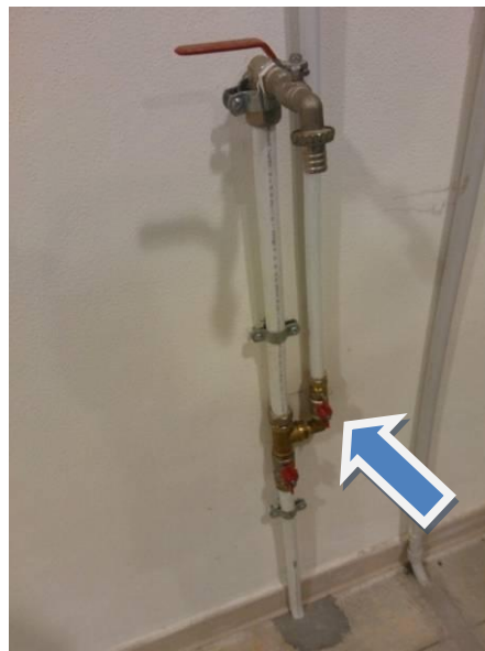
Figura 17: Rubinetto dell'acqua di raffreddamento dell'autoclave
