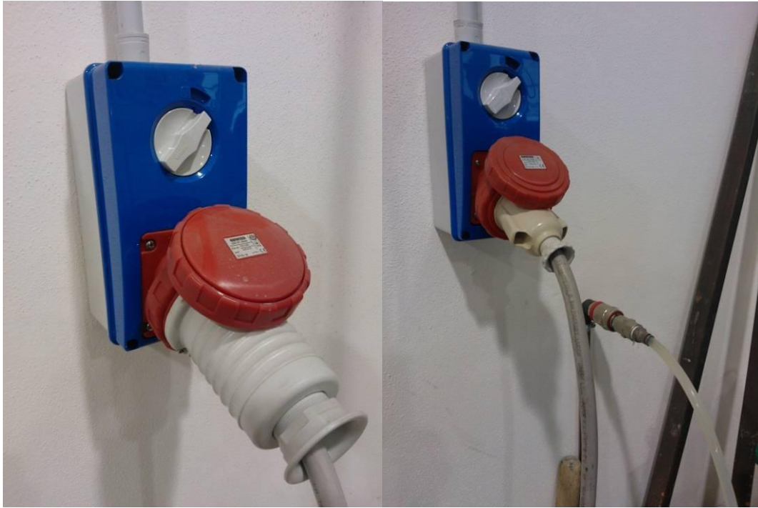
Figura 18: Interruttori corrente elettrica
