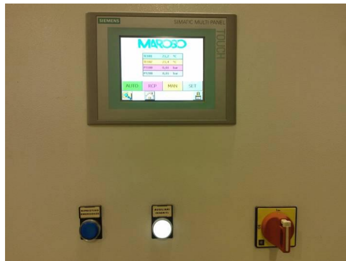
Figura 21: Pannello operatore dell'autoclave
