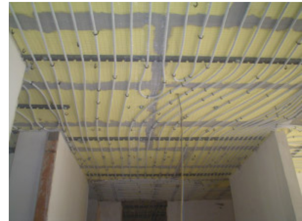
Pannelli annegati a soffitto
